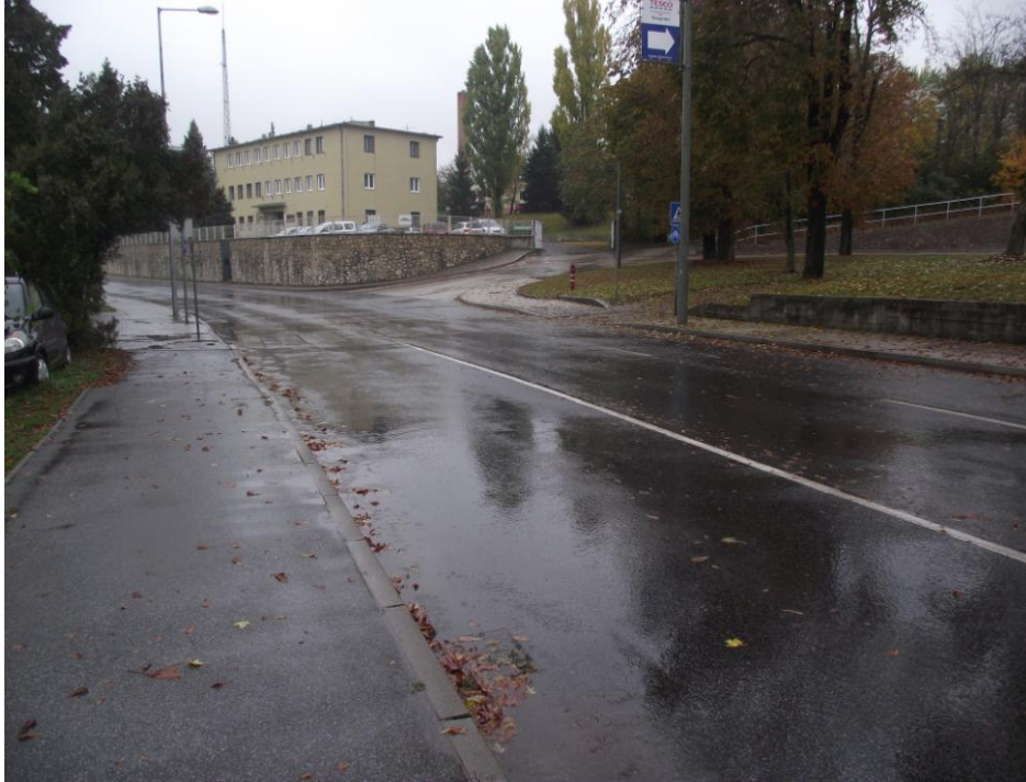
1. kép a bejelentésben szereplő eltömődött csapadékvíz elvezető
