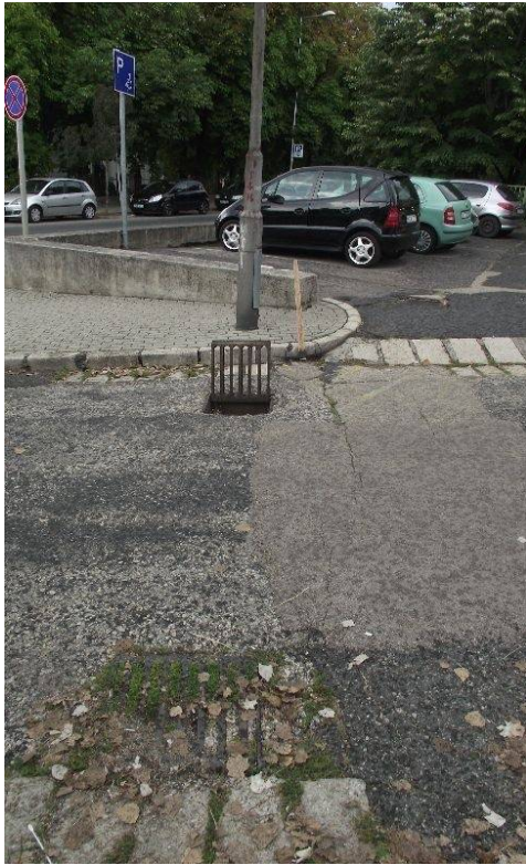
1. kép a bejelentésben szereplő eltömődött csapadékvíz elvezető
